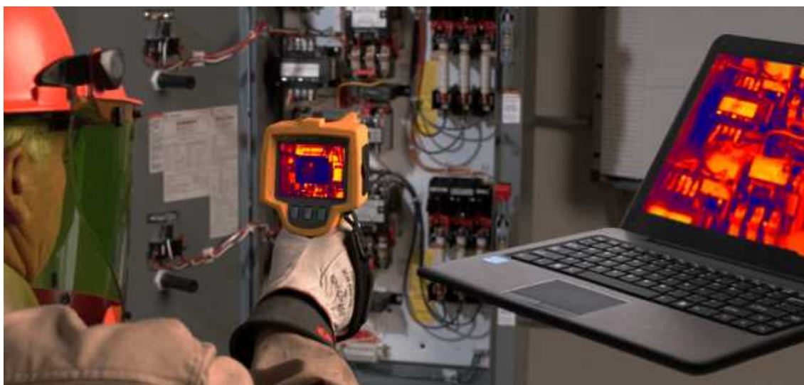
Рисунок 20. Пример проведения тепловизионного контроля электрошкафа
