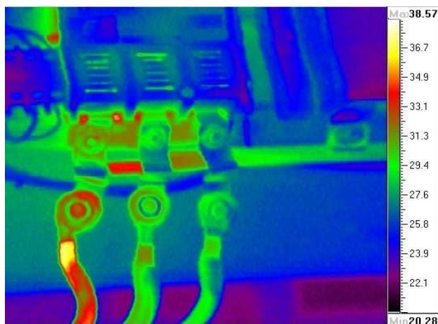
Рисунок 21. Пример термограммы контактных соединений с температурной шкалой
