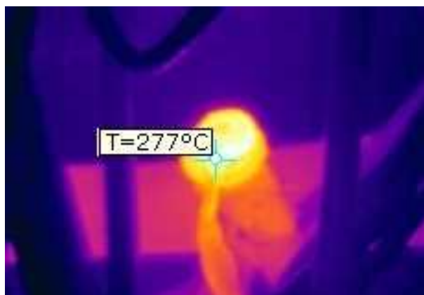
Рисунок 22. Пример обнаружения пожароопасного разогрева болтового контактного соединения
